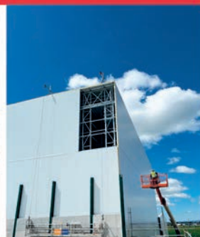
Tancament de silo mecanitzat
