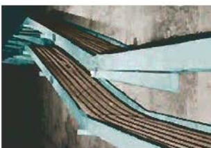
Protección de bandejas de cables.
