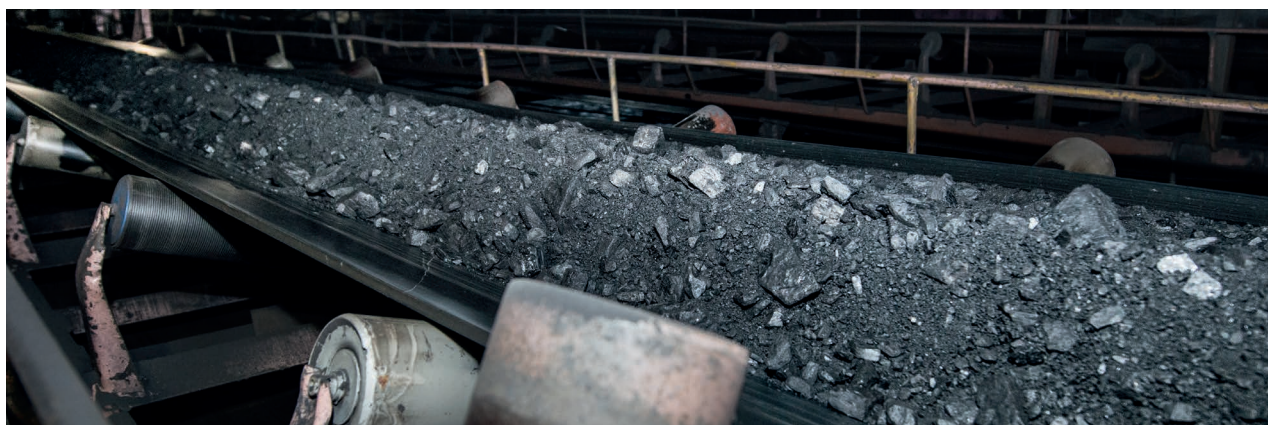
Aplicación I Banda de caucho en unas instalaciones mineras.
