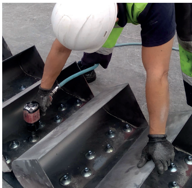
Montaje I Cangilones en una banda elevadora.
