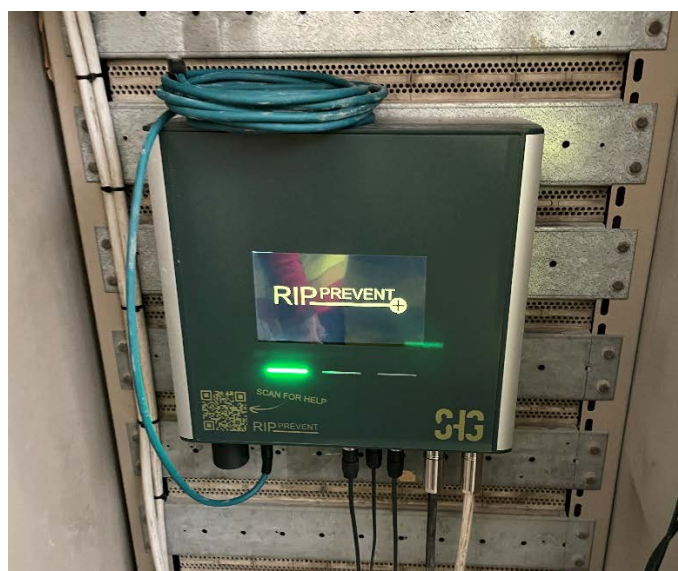
SHG Rip Prevent+ instalado y en funcionamiento.
